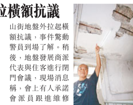
住客指樓宇天花石屎剝落是受附近地盤打樁影響。
