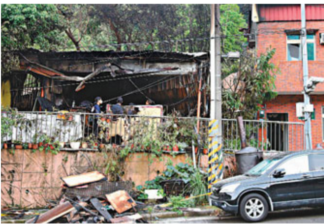
鐵皮屋頂被燒到焦黑傾倒。
