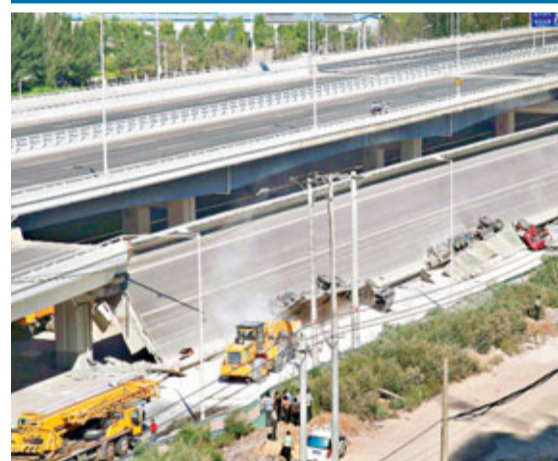
■國家級橋樑專家已抵達哈爾濱查塌橋原因。圖為日前坍塌的陽明灘大橋事故現場。資料圖片
