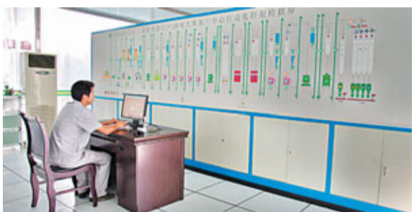
■福娃集團生產線控制室
