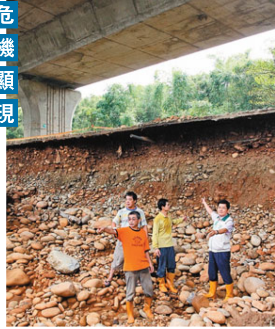
■颱風「蘇拉」過境，台中市沙鹿區六路里山坡地發生嚴重土石崩塌，高架橋橋墩旁多處土石被雨水掏空，危機顯現。中央社
