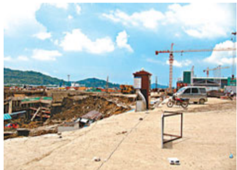
澳門大學新校區海底隧道橫琴段發生坍塌。
