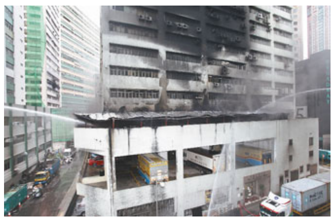
大廈外牆可見嚴重熏黑並出現石屎剝落。
