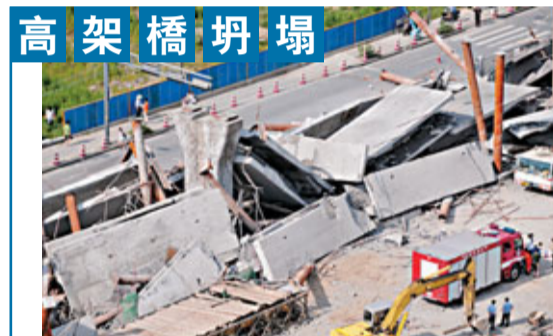
2日下午,位於杭州市區新業北路與德勝路口附近一座正在拆除的高架橋發生坍塌事故,造成1人死亡、3人受傷。
