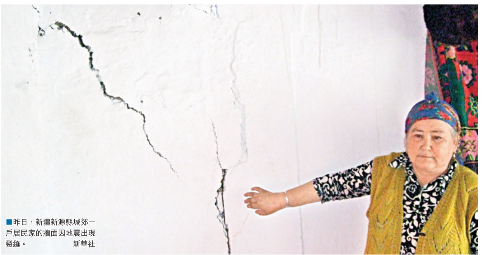
■昨日,新疆新源縣城郊一戶居民家的牆面因地震出現裂縫。
