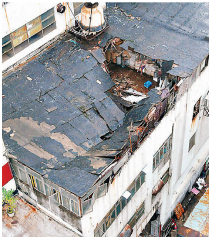
工廠大廈3樓平台的貨倉屋頂在暴風雨中出現大面積坍塌。
