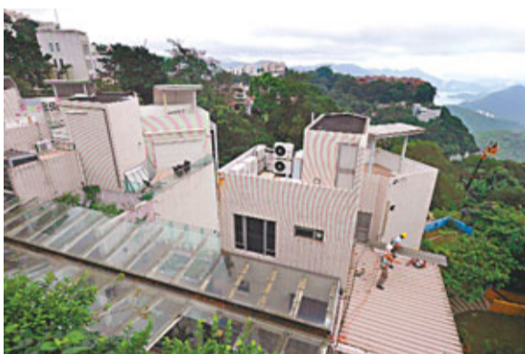
▲屋宇署日前再派員視察梁振英大宅，並無發現傳媒報道的「僱建工人房」或其他僱建物。資料圖片
