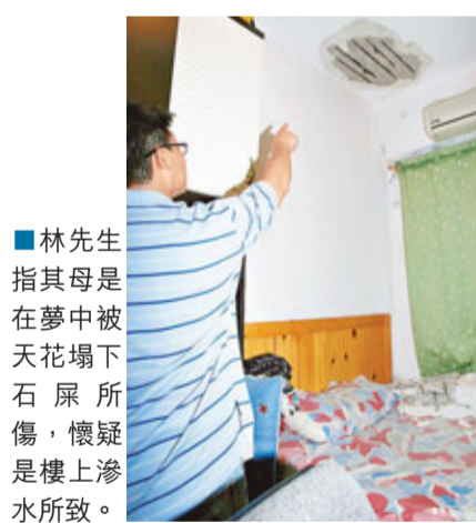
林先生指其母是在夢中被天花塌下石屎所傷，懷疑是樓上滲水所致。
