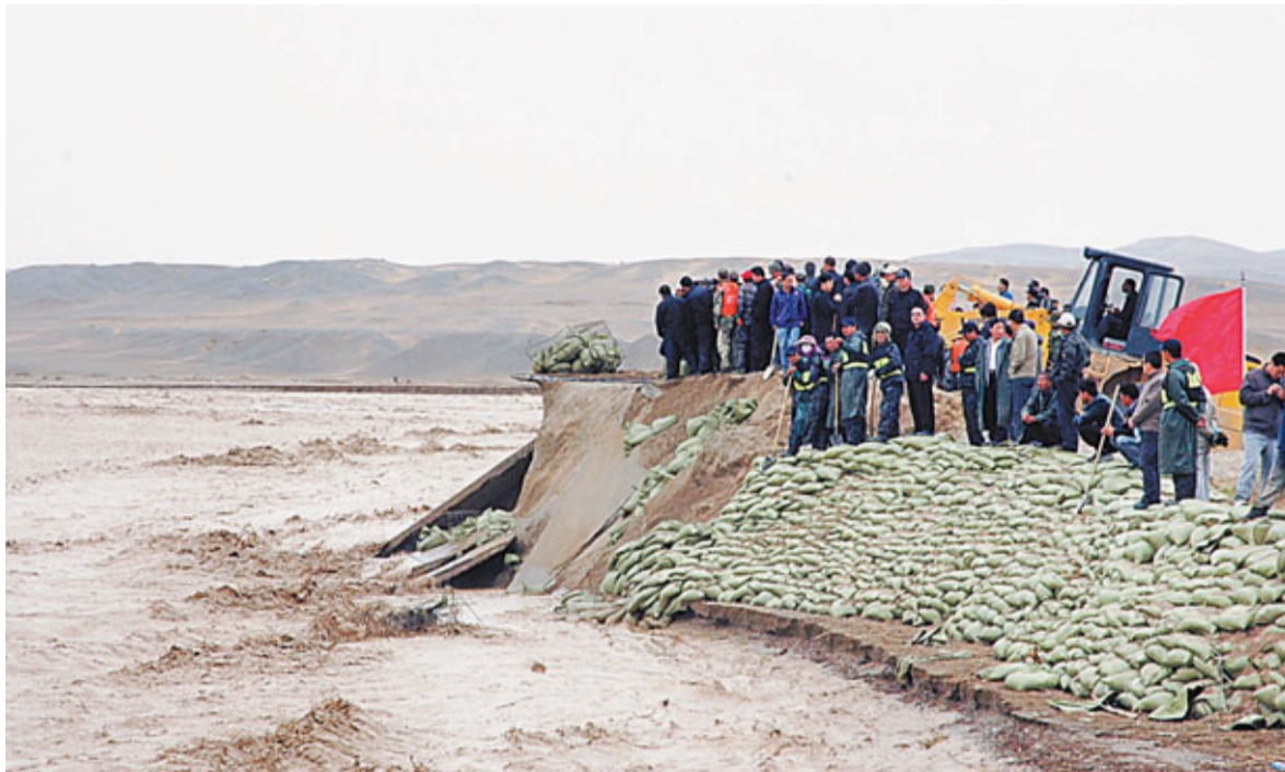
5日凌晨,敦煌市境內山洪暴發,洪水沖斷了唯一一條通往莫高窟景區的橋樑,景區現已關閉。
