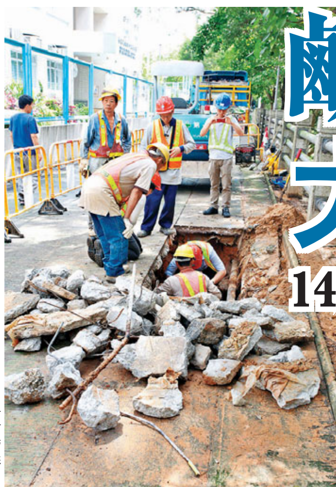
大埔曉運路李興貴中學對開發生煤氣管疑受爆水管影響受損現場。
