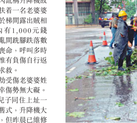
■ 工作人員在薄扶林道現場清理塌樹。
