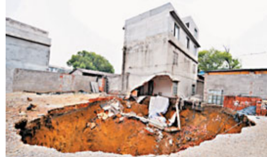
房屋底部地陷出深坑，部分牆體垮塌。新華社
