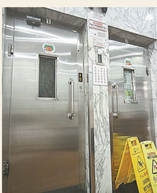
■ 金樓樓設有2部手拉開門式升降機，其中右方肇事的2號升降機昨日已暫停使用。
