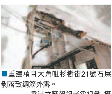
重建項目大角咀杉樹街21號石屎剝落致鋼筋外露。
