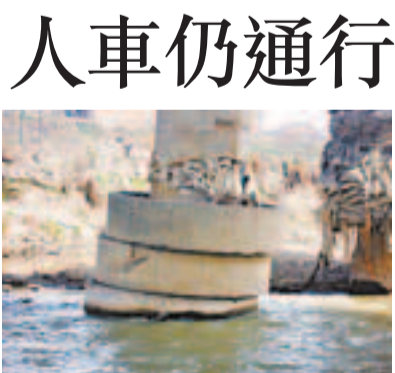
橋墩向一邊大幅傾斜。
