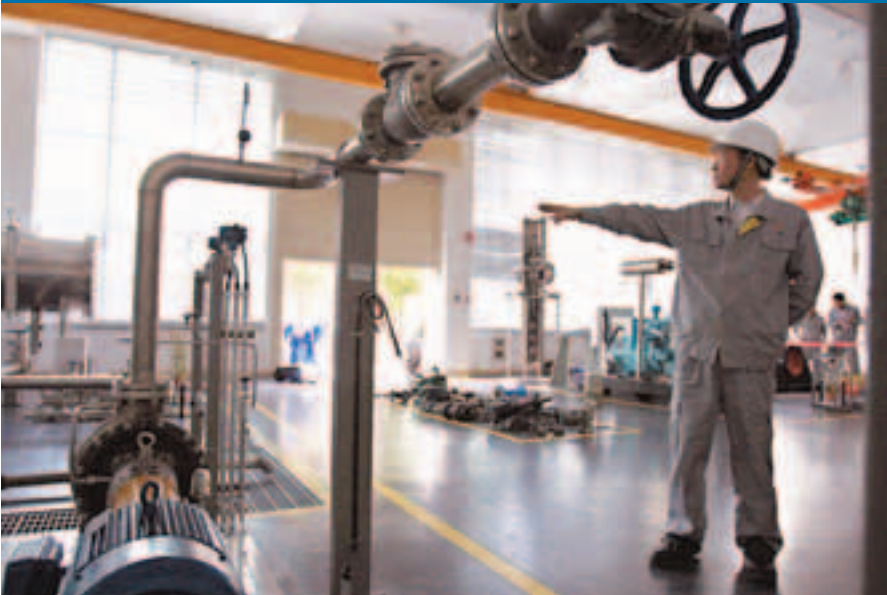
■中國核能發電站內部。
