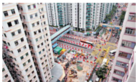
俊和已奪得觀塘線延線的部分工程合約，集團預計未來數年每年可取得10%以上純利增長。圖為黃埔站施工現場。
