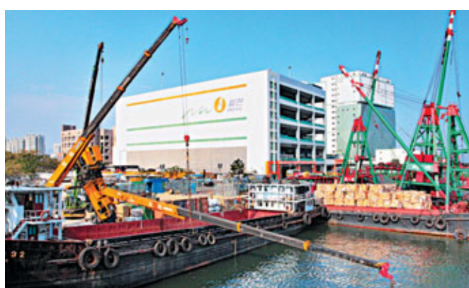
翻側險告墮海的吊臂車正由另一輛吊臂車吊起扶正。
