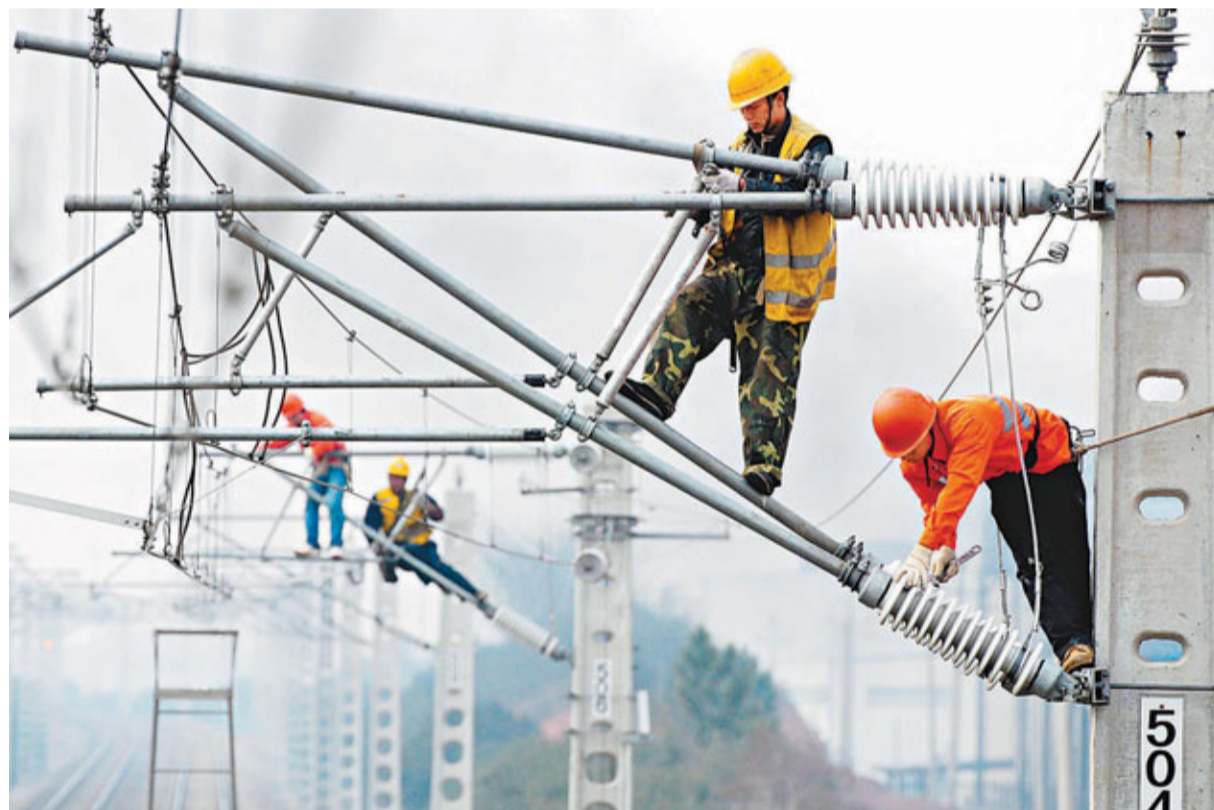
鐵路各部門準備迎接春運。圖為江西南昌鐵路供電段組織技術人員對京九鐵路江西向塘至廣東東莞段電氣化改造工程做開通前的檢查調整。新華社
