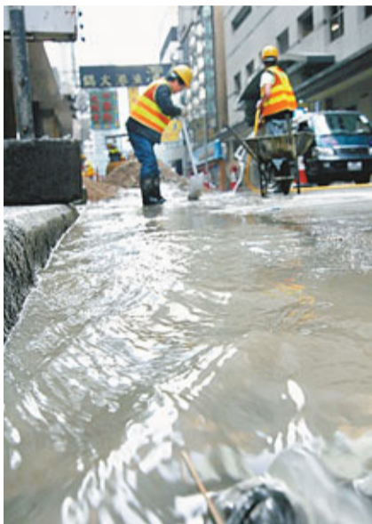
謝斐道爆水管,街道成澤國,工人忙於搶修。
