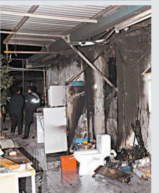
現場村屋外牆熏黑，部分雜物焚毀。
