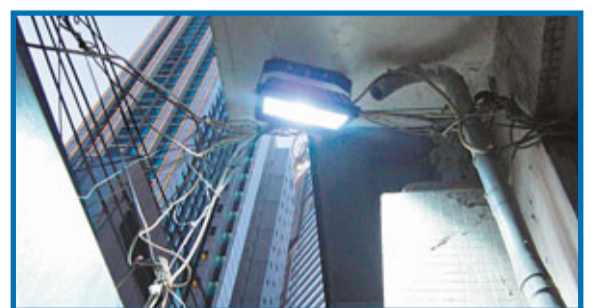
渣甸坊不少排檔會引電線至鄰近大廈取電。
