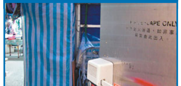
渣甸坊有排檔正對着走火通道，阻礙逃生。
