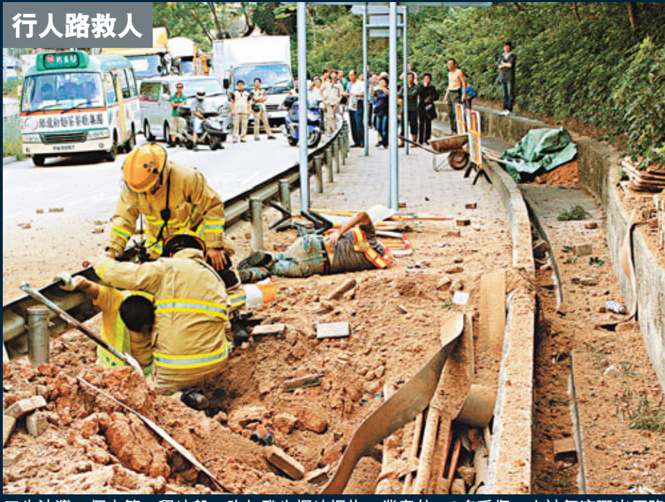
■牛池灣一個水管工程地盤,昨午發生掘地爆炸工業意外,2名受傷工人被氣流彈出馬路(左圖)。上圖為一名工人倒在行人路,在坑內工人奇蹟未有受傷。
