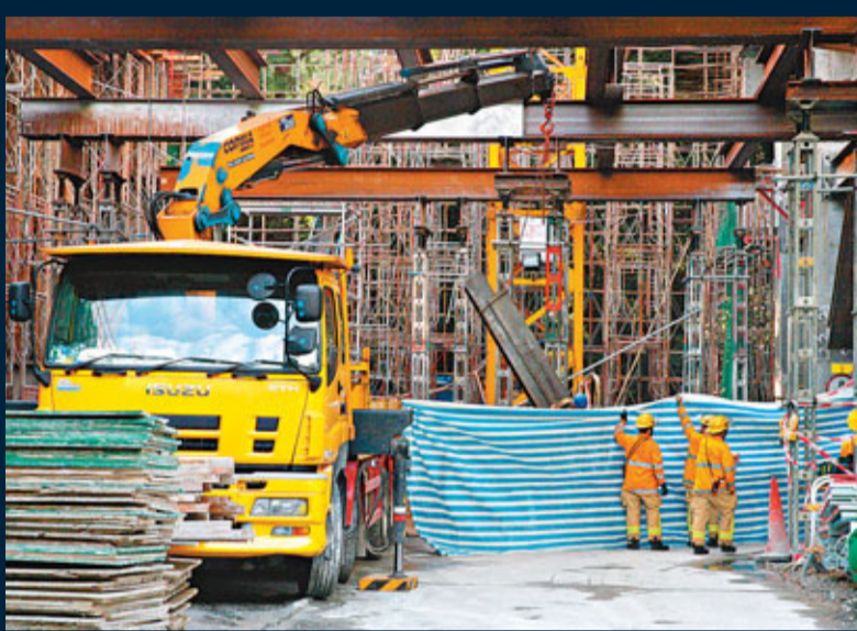
■吊臂滑落的工字鐵仍壓住工人，消防用尼龍布遮掩現場設法拯救。
