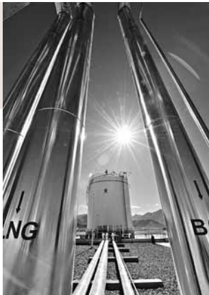
■西藏拉薩天然氣站的液化天然氣儲罐和輸送管道。 新華社
