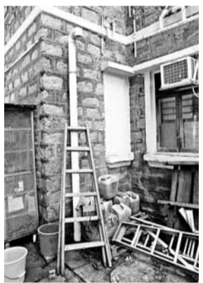
葵涌公園有一段水管被偷鐵黨偷走。
