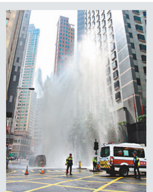
灣仔路與分域街交界地底鹹水管爆裂，射出水柱高達10層樓，極為壯觀。
