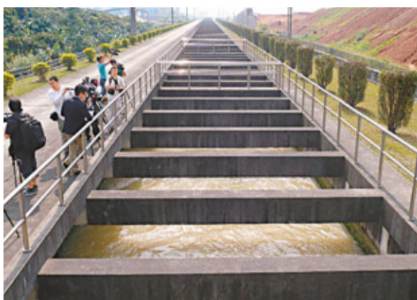
■本港多家傳媒獲安排參觀塘厦石山明槽的供港輸水網絡設施。 香港文匯報記者羅敬文 攝
