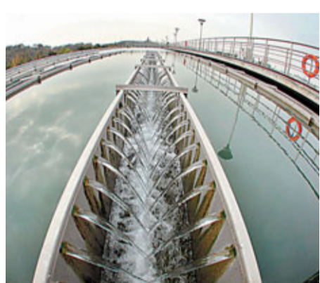
南通投入巨資建設水廠和供水管道，確保沿海地區居民喝上優質可口的長江水。圖為南通自來水廠一角。
