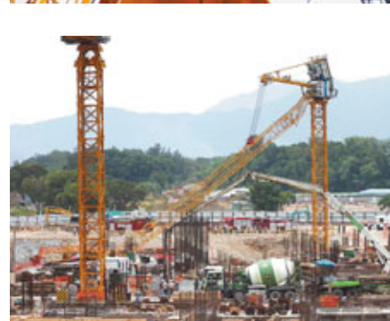
肇事天秤的吊臂下塌，控制艙則向前呈90度倒豎式折曲。
