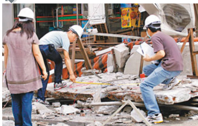
屋宇署調查發現屯門永發工業大廈簷篷地台曾被加厚，以致批盪覆蓋排水明渠，使簷篷內的鋼筋因積水而受嚴重銹蝕。
