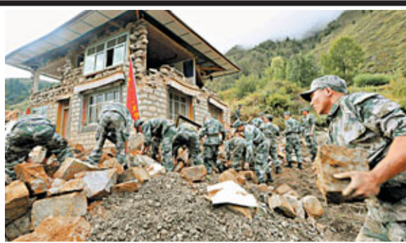
■西藏亞東縣房屋受損，軍人趕緊清理。
