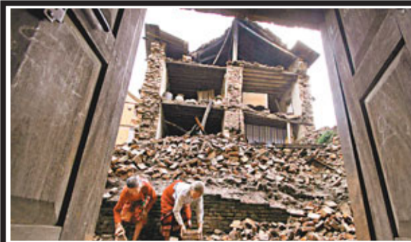
■尼泊爾一座三層高樓房有半間塌牆。
