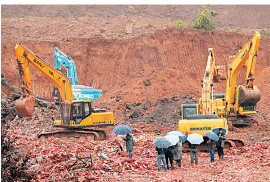
西安山體滑坡處房屋被埋，多架起重機正極力挖掘事故現場。
