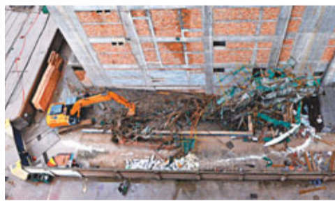
■ 西安凱旋大廈腳手架坍塌事故現場。 新華社
