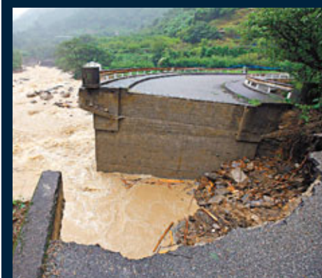
■奈良縣一條公路大塊崩塌。
