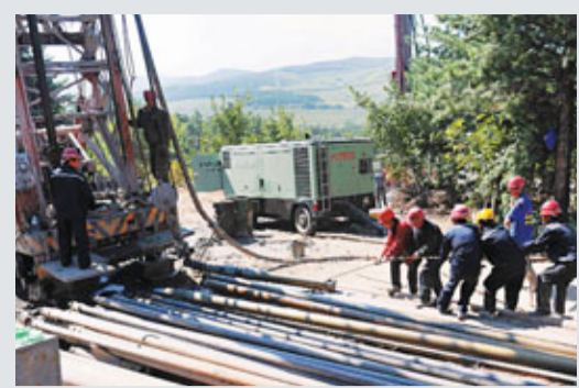
■黑龍江恒太煤礦透水事故救援現場。資料圖片
