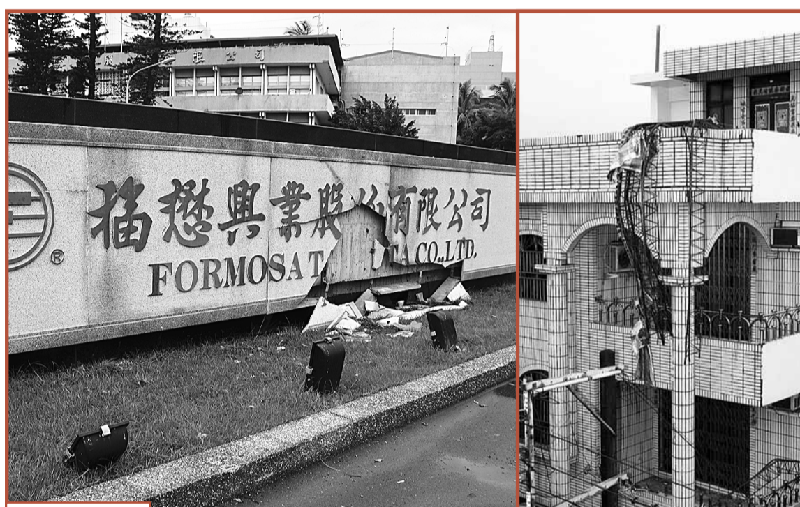
雲林下冰雹 斗六石榴班近日突遭冰雹、龍捲風侵襲，當地一間公司員工宿舍鐵皮屋頂被掀落，部分碎片掉落掛在民宅陽台上，連門口大理石的招牌也遭殃，28日吊離掉落物。中央社
