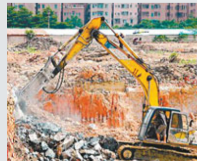
穗最大保障房被勒令停工。圖為該項目施工方被指偷運污染土壤掩埋。
