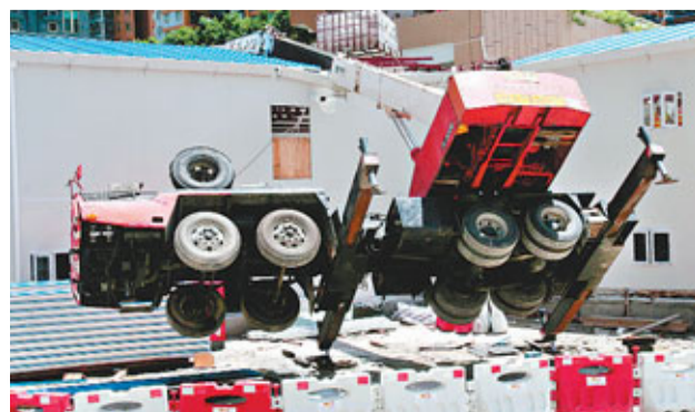
肇事吊臂車傾側,吊臂與吊運的鐵籠連貨物壓在屋頂上。
