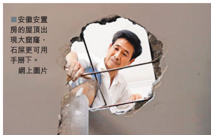
安徽安置房的屋頂出現大窟窿，石屎更可用手掰下。
