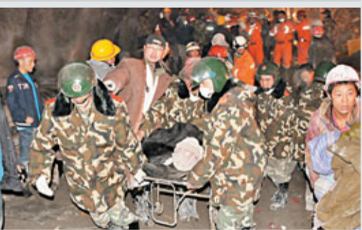
■被困於雲南迪慶塌方隧道內的人員被安全救出。
