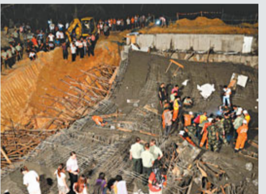
海南省萬寧市加神公路上正在加固的太陽河大橋發生坍塌事故。
