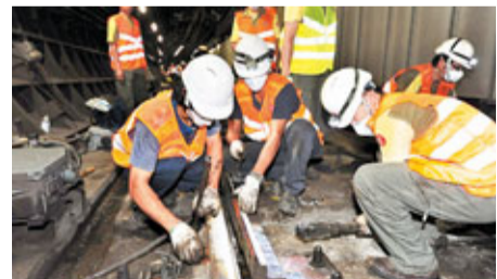
港鐵上環站前晚封閉後，工程人員隨即拆除站內的信號系統。
