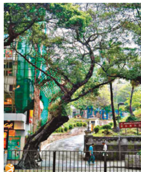
尖沙咀彌敦道一棵13米高細葉榕,因其結構嚴重受損並受真菌感染腐爛,昨日康文署派員移除。康文署圖片
