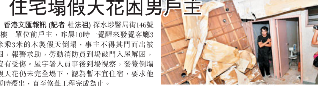
■ 塌下的巨型假天花幸未壓傷男戶主。
