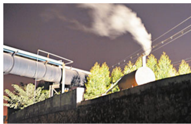
廣西貴港鋼鐵公司軋鋼廠發生煤氣泄洩事故現場。
